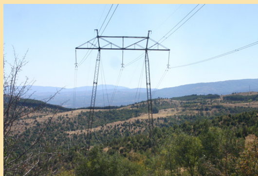
400 kV стълб в Кресненското дефиле
